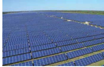
Solar Station «Belarusneft», 56 MW, Gomel region
