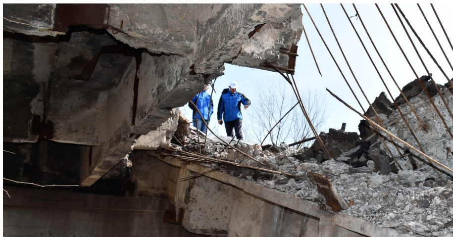
Спостерігачі СММ ОБСЄ біля пошкодженого моста в с. Кліщівка Донецької області (ОБСЄ/Моніка Олжєвська)
